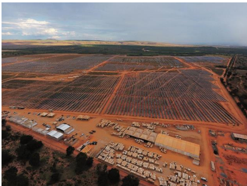
UFV de 185 MWp em Pirapora (MG).
